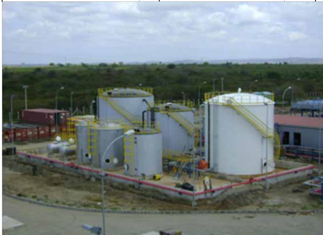
Figura 1 - Tanques de armazenamento atmosféricos e seus componentes
